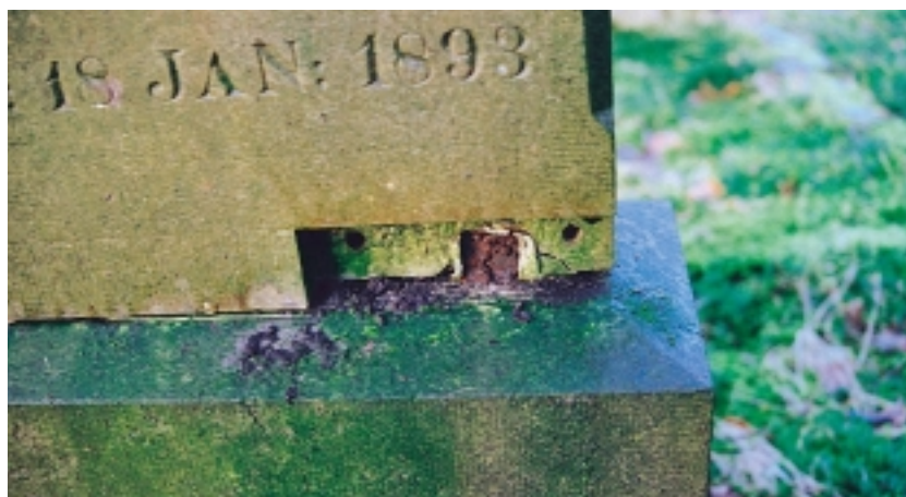
Eerder veroorzaakte deze dook schade. Het daarna ingezette blokje hardsteen is door roest weggedrukt
