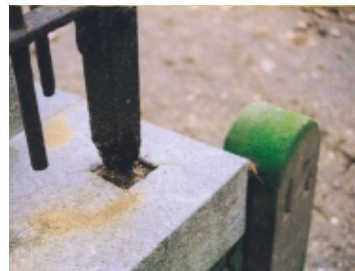
Begin van scheurvorming door een roestende bekkaluster. Ingrijpen kan vervolgschade voorkomen
