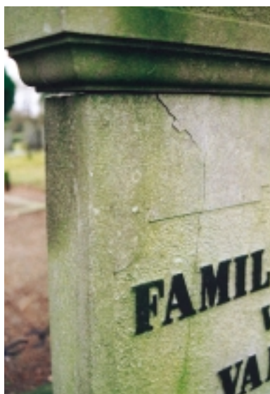
De roestende dook verradert zich door schilfer en scheur. Ingrijpen kan vervolgens schade voorkomen en wel door: doken doorzagen, uitboren, nieuwe roestvast stalen doken plaatsen in dekstuk, scherf lijmen, steek insluiten met kram en dekstuk met doken plaatsen en eventueel afvoegen
